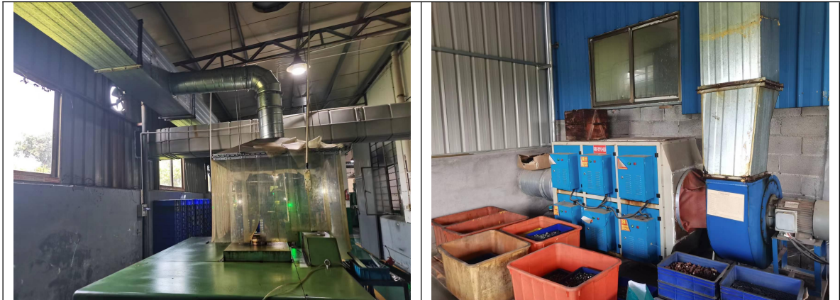
每台冷镦成型机上方安装集气罩，连接废气处理设施（油污净化器），废气经处理后 15m 高排气筒排放
