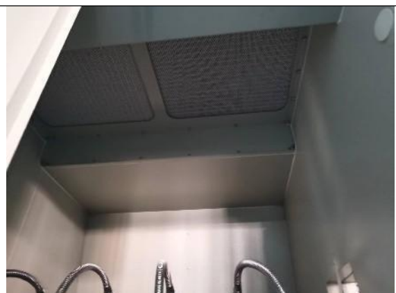
顶部集气抽风系统
