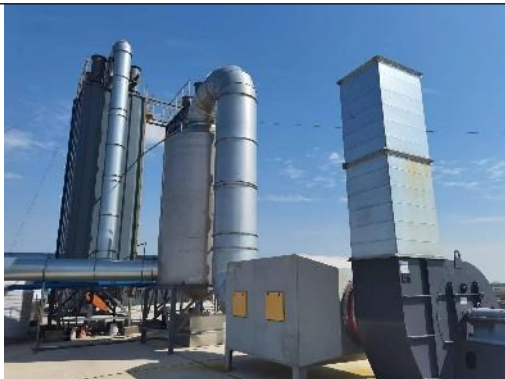
湿电除尘电捕焦油器+旋流喷淋塔+除雾器+活性炭吸附柜，废气经处理后 15m 高排气筒排放
