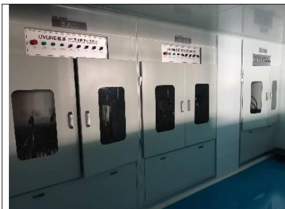
静电除尘室、火焰处理室密闭
