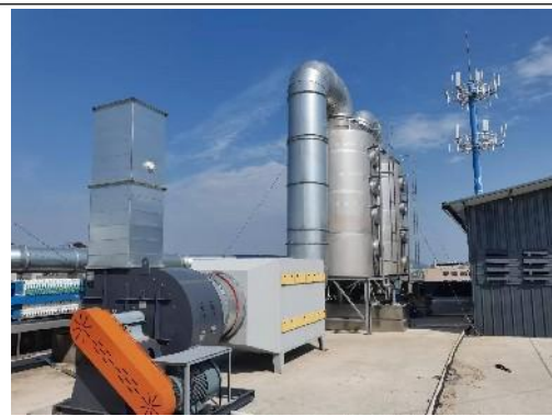
旋流喷淋塔 1+旋流喷淋塔 2+除雾器+活性炭吸附柜，废气经处理后 15m 高排气筒排放
