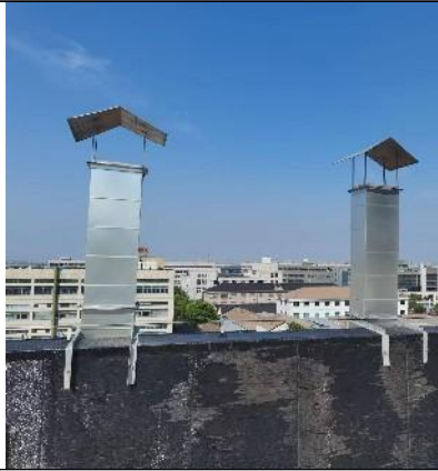
15m 高排气筒排放
