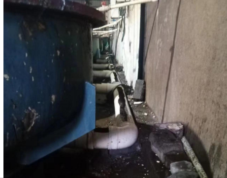
废水收集管道
