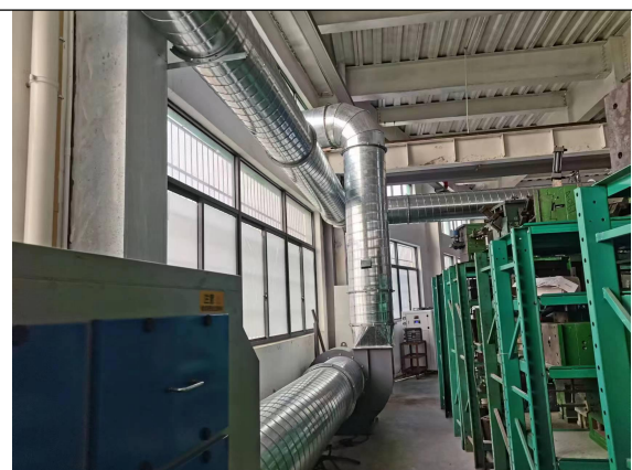
废气输送管道
